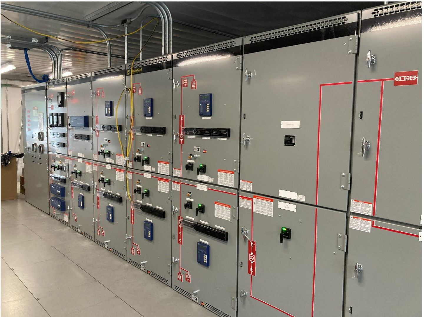
New Switchgear SE
